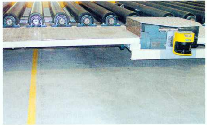
□ Die gelbe Linie markiert die Verlegung der Maßverkörperung im Boden. Ebenfalls gelb: Der Sicherheits-Laserscanner ‚S3000‘, der den Fahrweg des Verschiebewagens überwacht.
