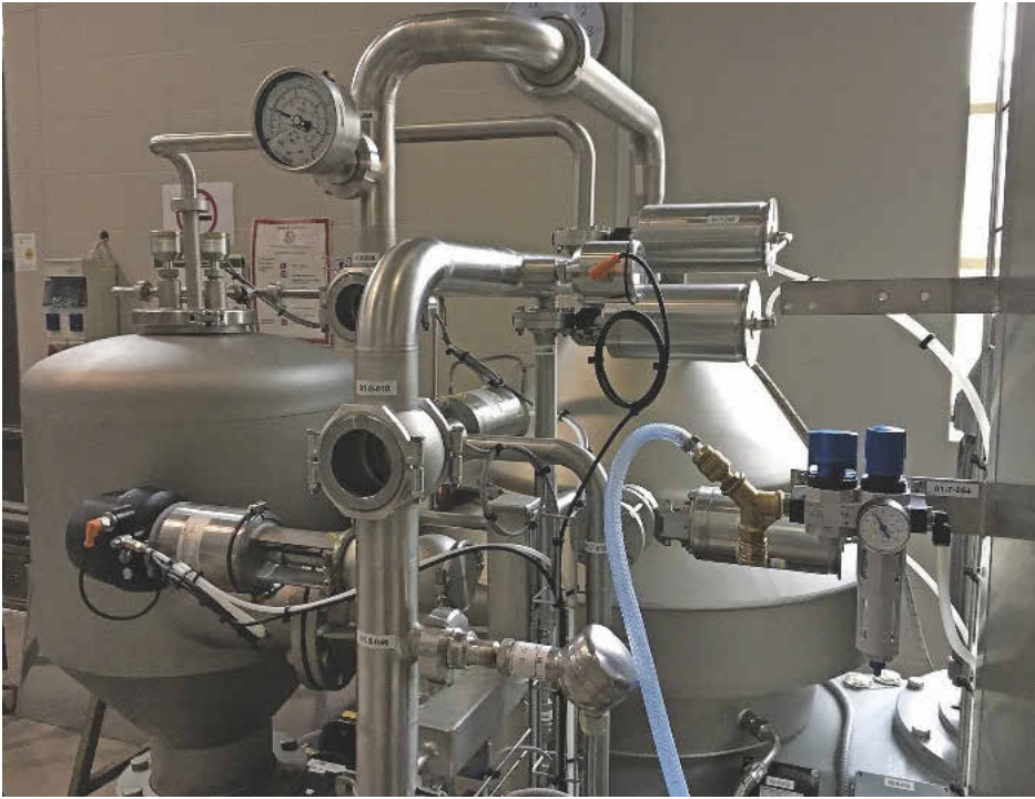
Die Trübungsmessgeräte von Seli kontrollieren und überwachen bei Carlsberg die Produkte im Filterkeller und steuern die Separatoren
