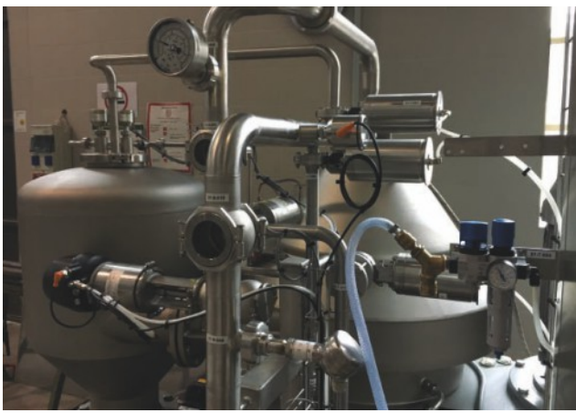
STS03- Trübungs- messung an einem Separator
