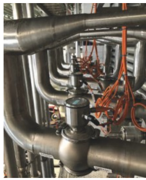
SLI03-Leitfähigkeitsmessung in einer CIP-Anlage
